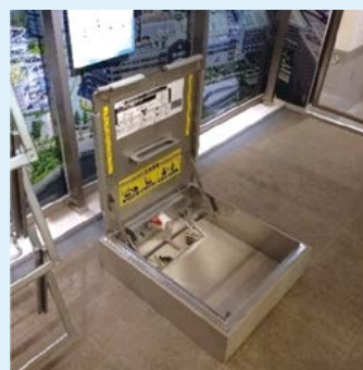
避難ハッチ開放の様子
