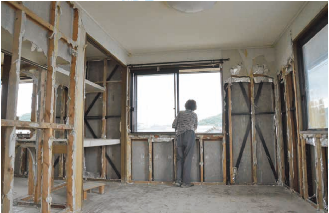
西日本豪雨で自宅が2階まで浸水した岡山県倉敷市真備町の女性。知人の呼び掛けを断って自宅にとどまり、首まで水に浸かりながら救助されるのを待った。
