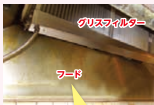
ちゅう房のフード内の油脂による汚れ
